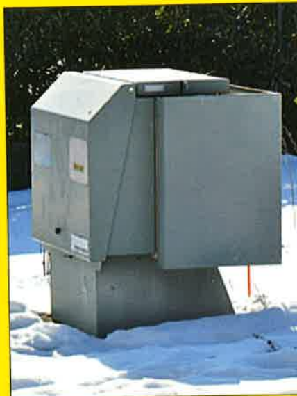
Un transformateur électrique.
