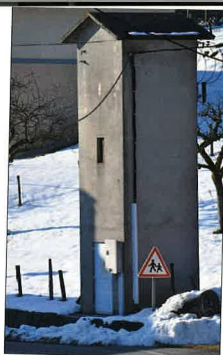
Le transformateur électrique du Chef-Lieu qui sera prochainement détruit et remplacé.
