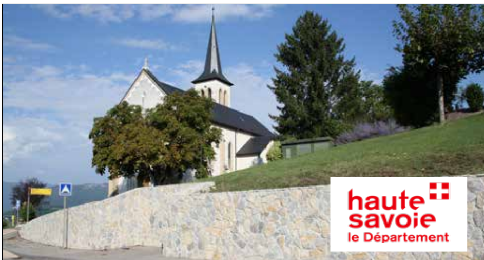
Une barrière sera prochainement installée sur ce mur.
